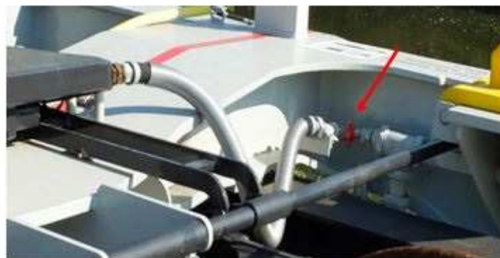
Absperrhahn in geschlossener Position
