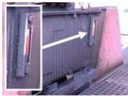
Bild 11: Ölbehälter der Hydraulikanlage mit Schauglas
